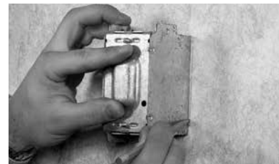
Figure R5. Marquage du contour sur le mur
